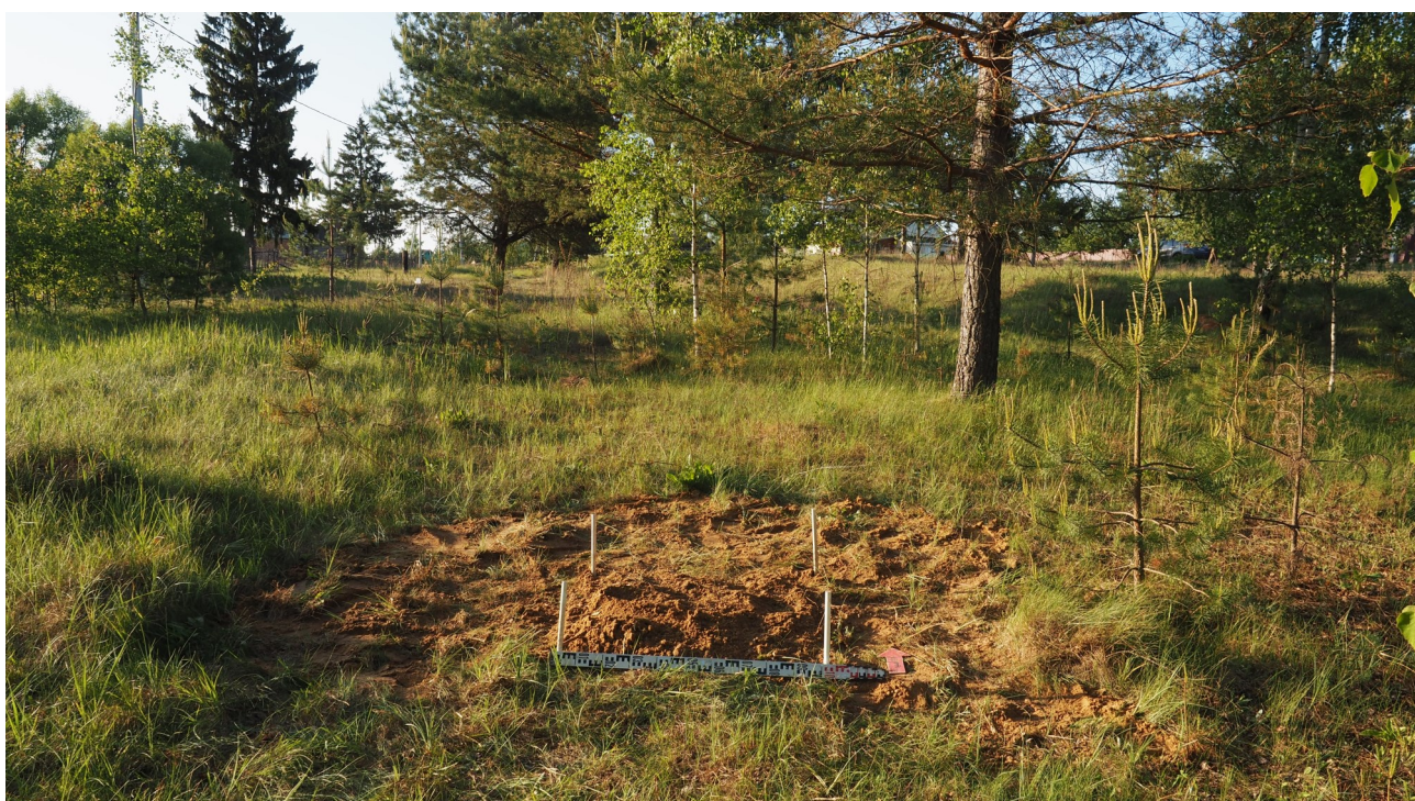
Рис. 44. Калужская область, Думиничский район. 2023 г. Археологическое обследование по объекту: «Уличные газопроводы дер. Ясенок». Шурф 3 после засыпки. Вид с юга.
