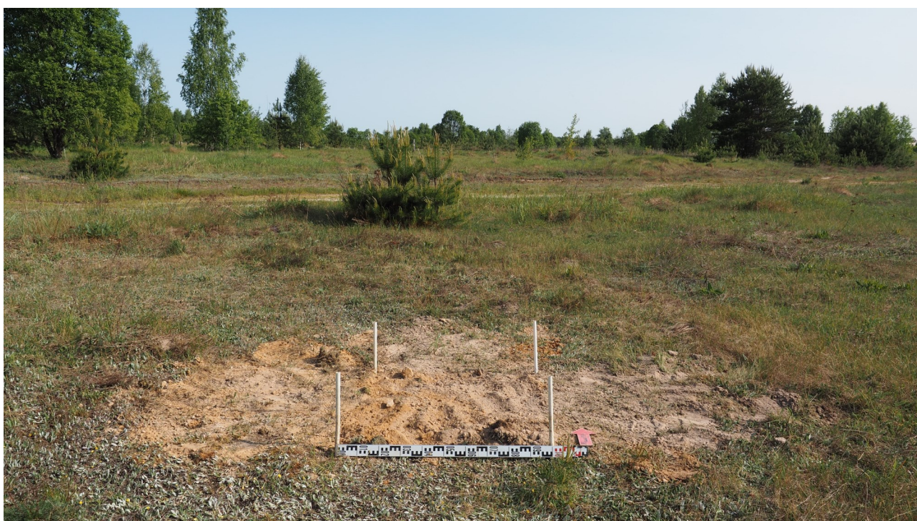
Рис. 52. Калужская область, Думиничский район. 2023 г. Археологическое обследование по объекту: «Уличные газопроводы дер. Ясенок». Шурф 5 после засыпки. Вид с юга.
